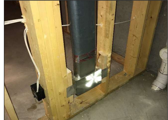
10. Aire de retorno canalizado y sellado.
