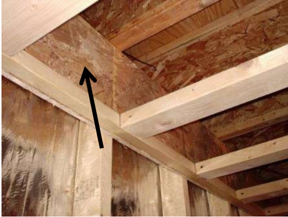
5. Madera contrachapada utilizada como bloqueo contra el fuego desde el soffito hasta las cavidades de la pared.
