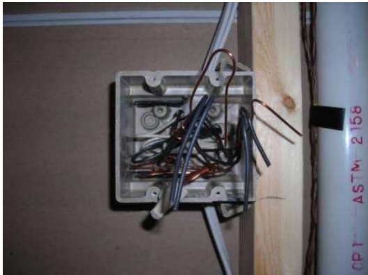
1. La instalación eléctrica tiene todas las cajas preparadas y listas con extremos de 6 pulgadas como mínimo.
